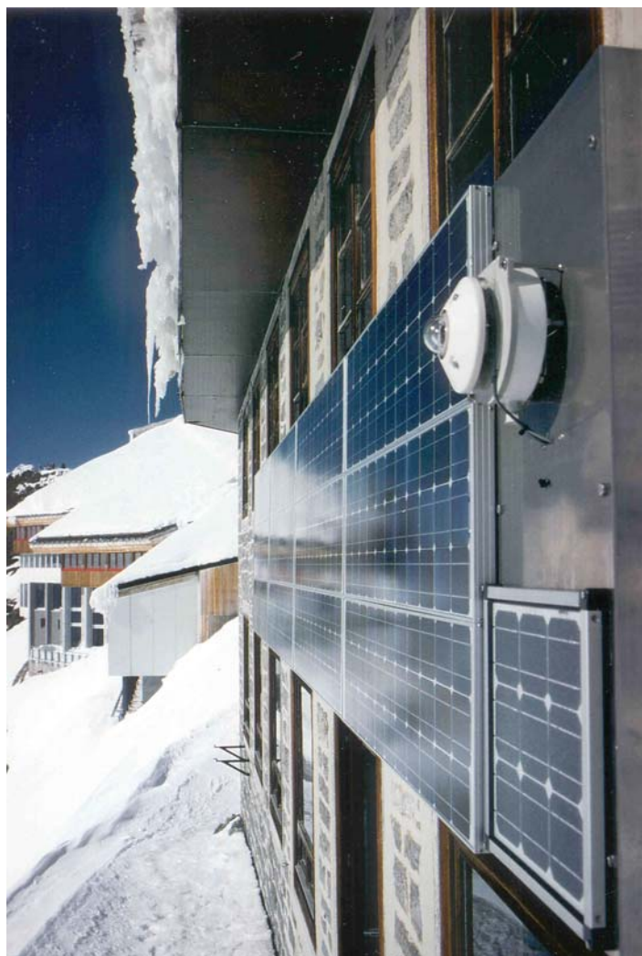
Blick auf die eine Hälfte des Solargenerators der PV-Anlage (1,13 kWp) an der Fassade der hochalpinen Forschungsstation Jungfrauoch (HFSJG, 3454 m). (Bild: Heinrich Häberlin, Buch Photovoltaik [2])
