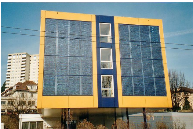
PV Fassade an der avenue de Rhodanie 64 in Lausanne mit 7'680 Wp (1999)
